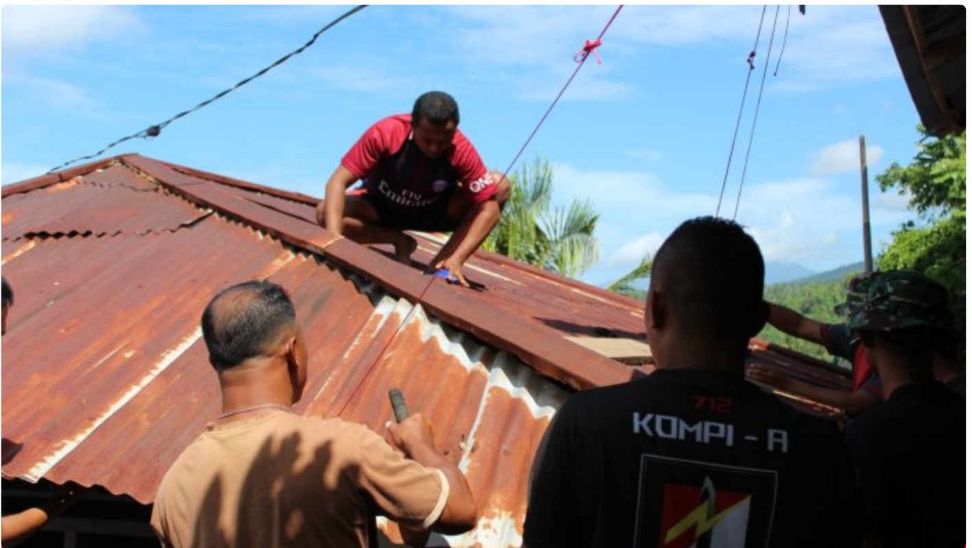
Pembongkaran Bangunan Rumah lama, Keluarga Gavin Karaki Pemema Bantuan. RTLH TMMD Ke 116 Kodim1310 Bitung
